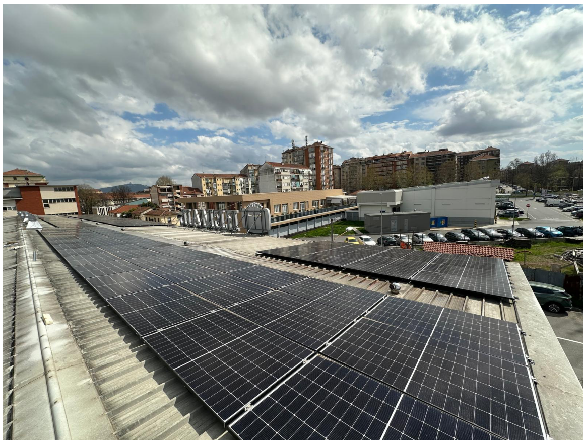
Nuovo impianto fotovoltaico di Via Orbetello, Torino
